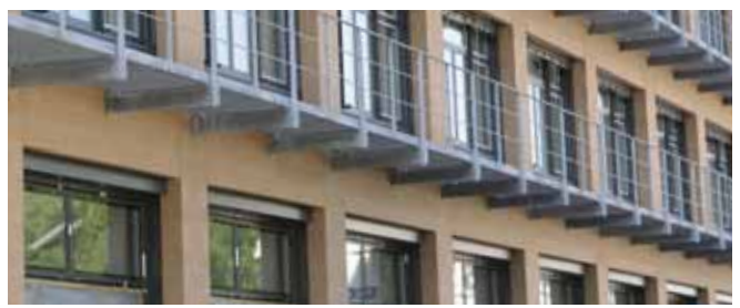
Befestigung von Fluchtwegen/Fluchtbalkonschwert
