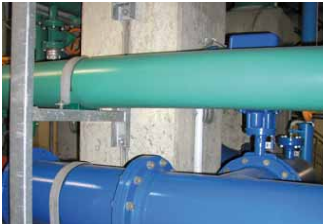
Rohrleitungsunterstützung an senkrechter HZA-Schiene
